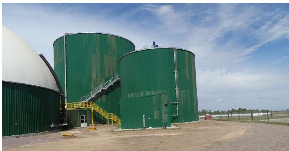
Figura 21 - Digestores en secuencia en una planta de biogás. Fuente: Elaboración Propia
