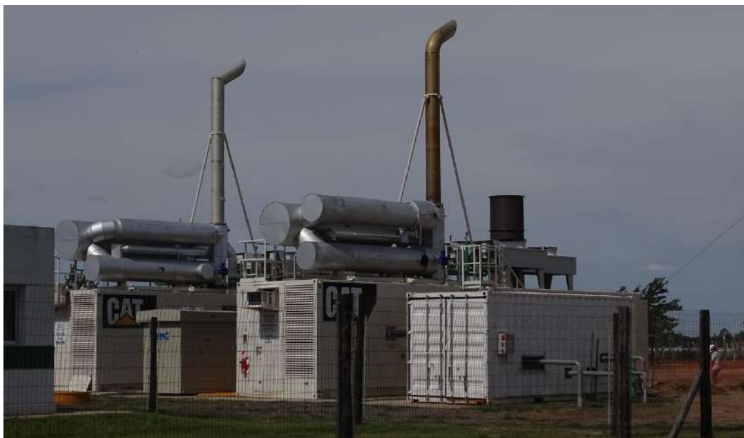
Figura 38 - Cabinas de insonorización para motogeneradores a biogás, y silenciadores para el escape de gases de combustión. Fuente: Elaboración Propia
