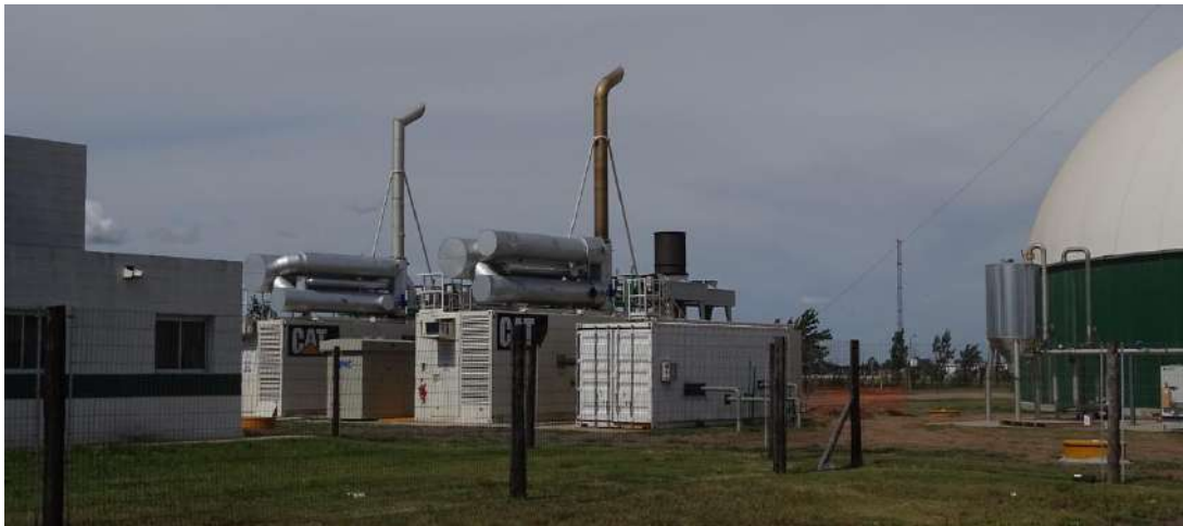
Figura 23 - Motogeneradores en disposición modular, con cabina de insonorización, en una planta de biogás. Fuente: Elaboración Propia.
