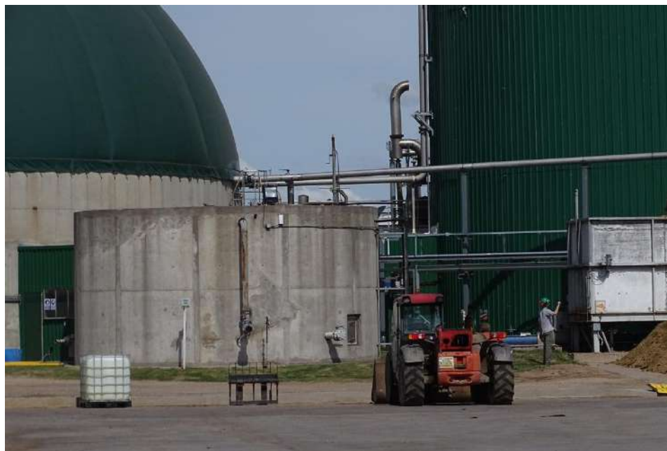
Figura 20 - Tanque de recepción y almacenamiento de residuos ganaderos en planta de biogás. Fuente: Elaboración Propia
